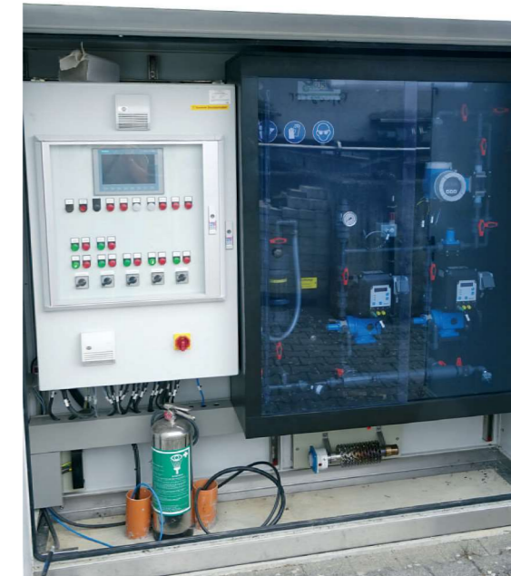
Kläranlage 8.000 EW – Innenansicht Technischschrank
