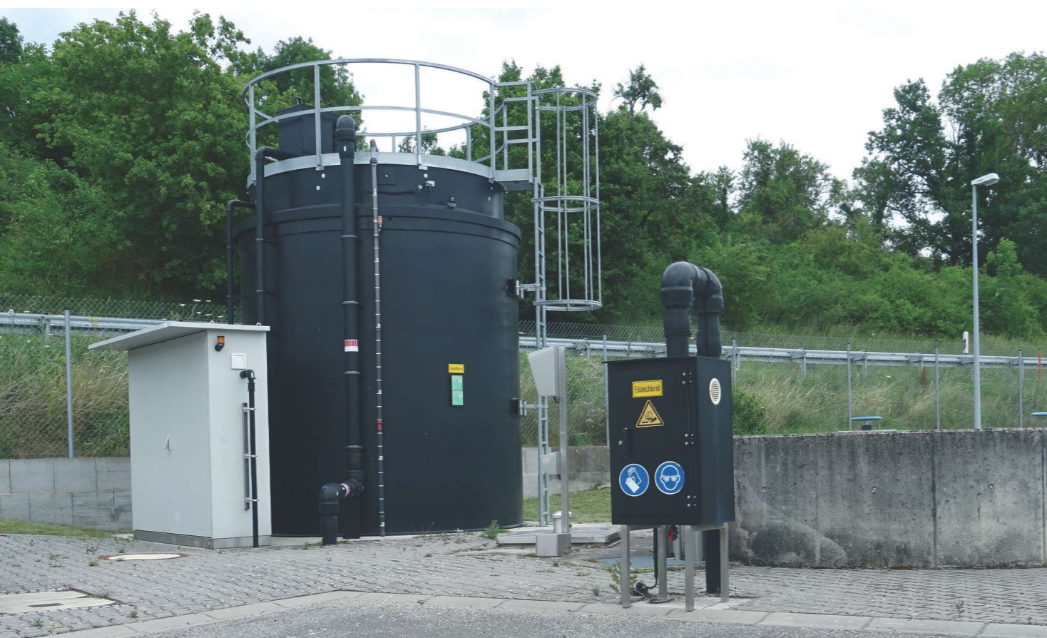
Kläranlage 8.000 EW – Abfüllplatz mit Annahmestelle, Behälter, Technischschrank
