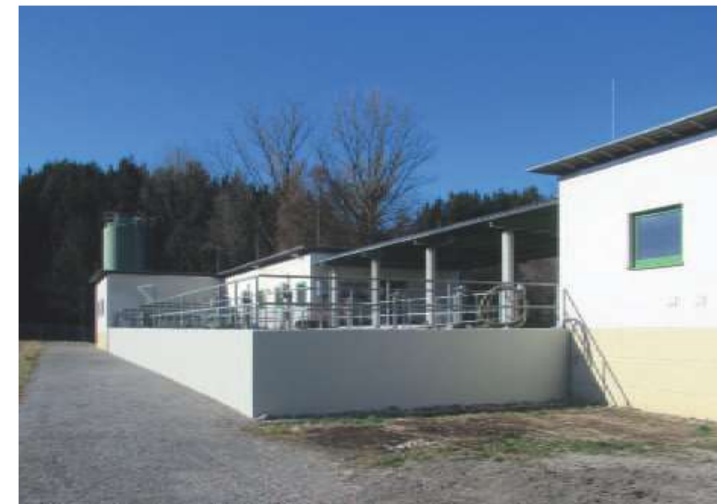
Kläranlage Hechingen: Aktivkohle-Adsorption-Flockungsfiltration
