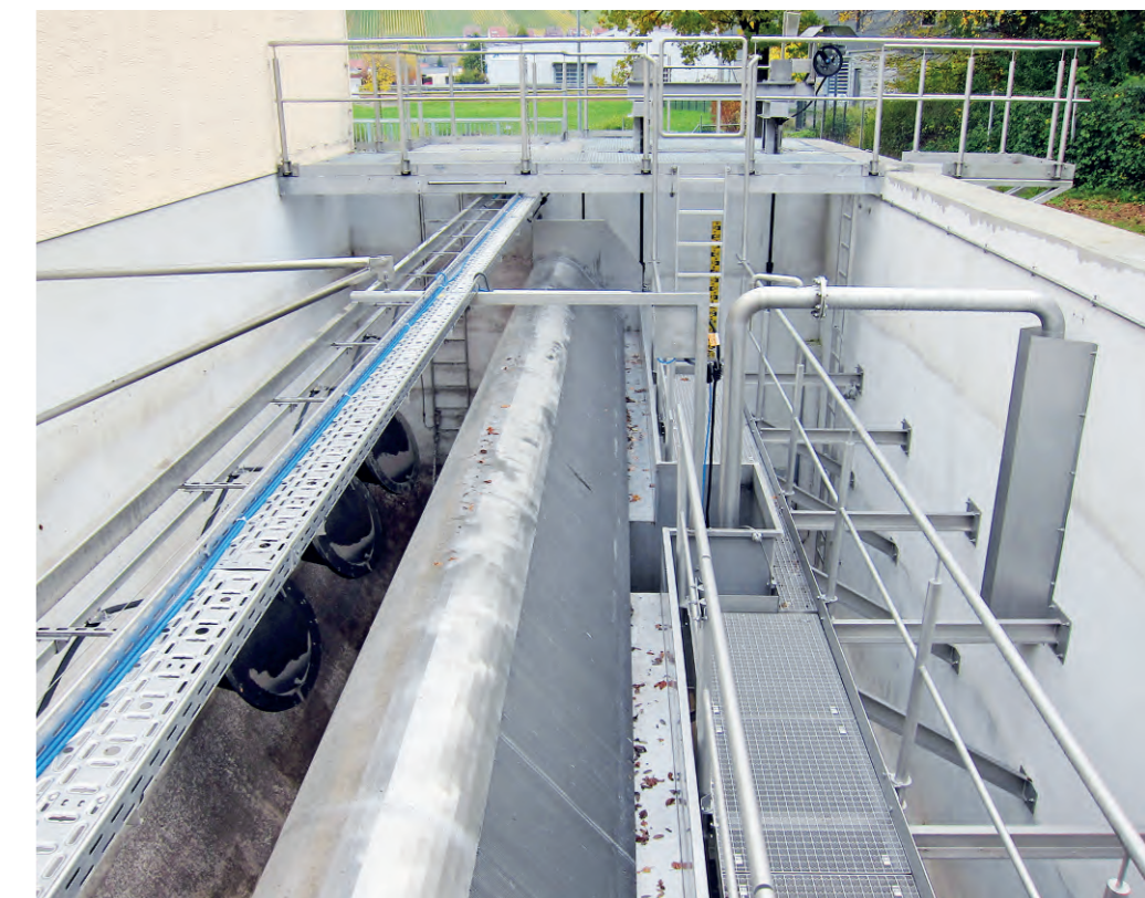
Beckenüberlauf, Ausrüstung mit Lamellenfeinsieb
