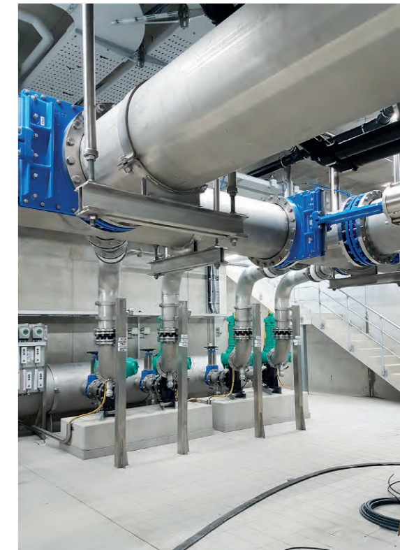
Pumpstation im Inneren des neuen Technikgebäudes
