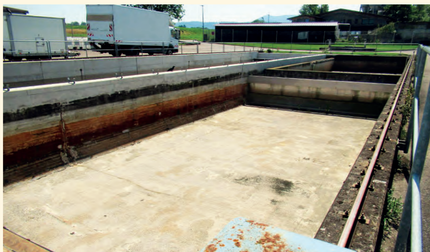
Weilheim Teck – Vorklärbecken
